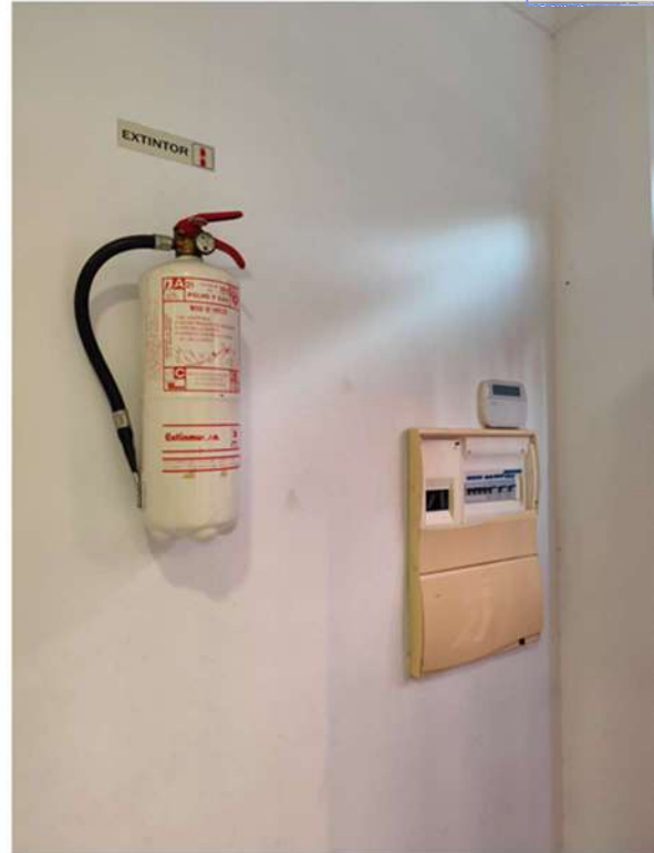
Cuadro general de mando y protección (estado actual)
